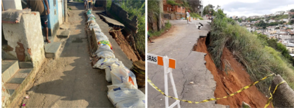
Figura 4 e 5: Imagens do deslizamento na Rua José Orozimbo de Oliveira.
